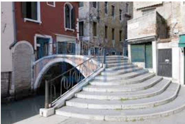
Marode Gebäude, Treppen usw.
